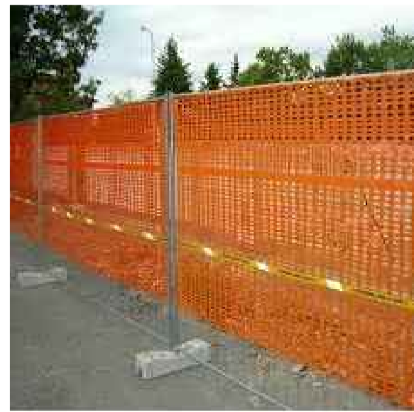
RECINZIONE SOLIDA ANTINTRUSIONE CON SEGNALE LUMINOSA SE INSTALLATA SU BORDO STRADA E IN CORRISPONDENZA DELLE PARTI COMUNI ALL'INTERO COMPLESSO EDILIZIO
